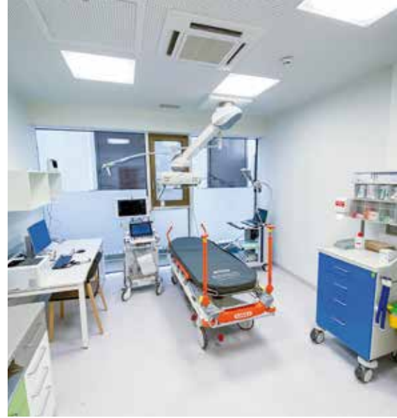
UNTERSUCHUNGSRÄUME. Für eine optimale Raumakustik wurden Lochdecken verwendet.
